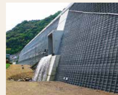
多様な現場に対応した壁面構成
